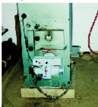
Une installation de chauffage qu'il convient de rénover au plus vite.
