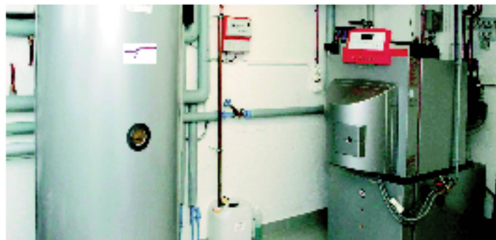
Une production de chaleur efficace est garantie avec une chaudière à mazout moderne.
