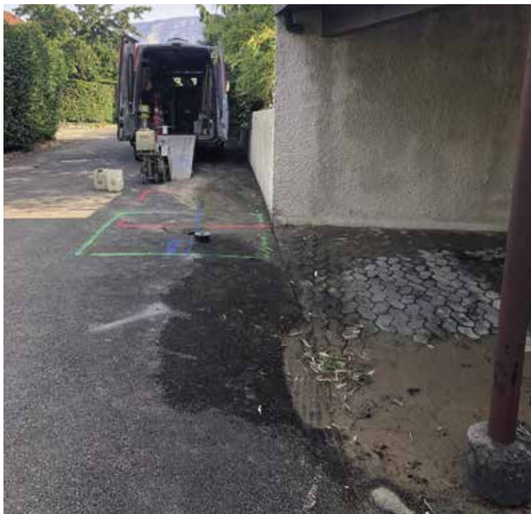
L'emplacement en sous-sol de la fuite d'eau est identifié.
