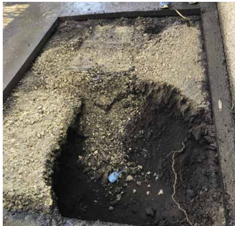
La fuite d'eau en sous sol.
