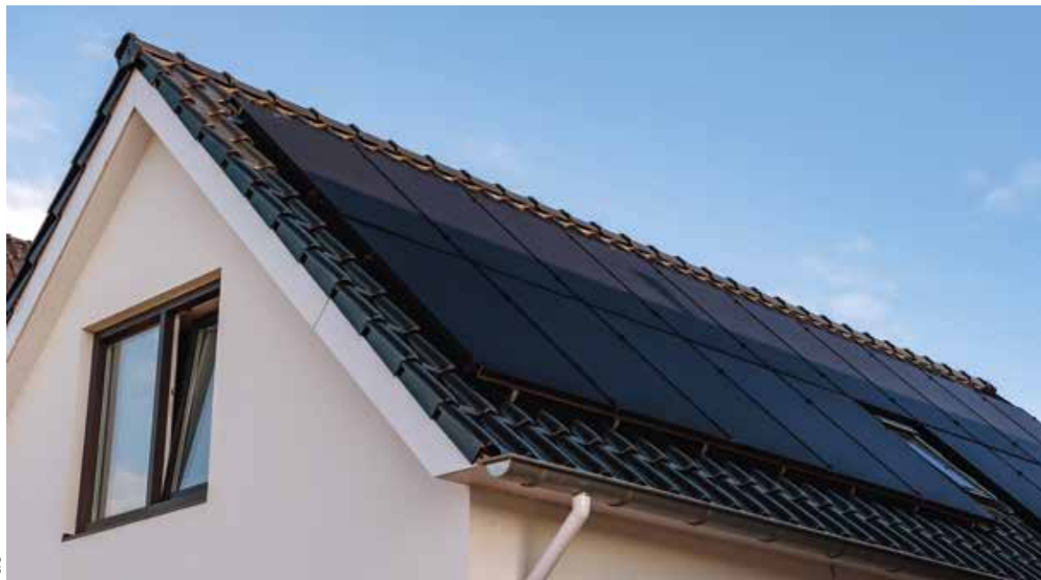
Une centrale solaire fait aujourd'hui partie des équipements standards d'une villa.
