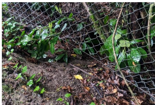
Figure 13. Passage sous une clôture. Les renards ont profités d'un petit espacement pour créer un passage.
